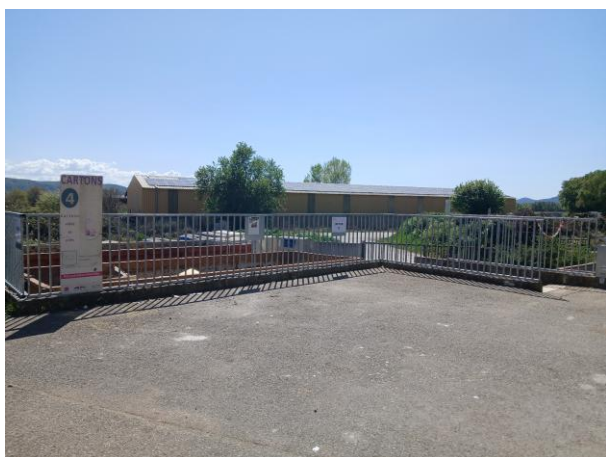
Déchèterie Oraison – Gardes corps fixes
