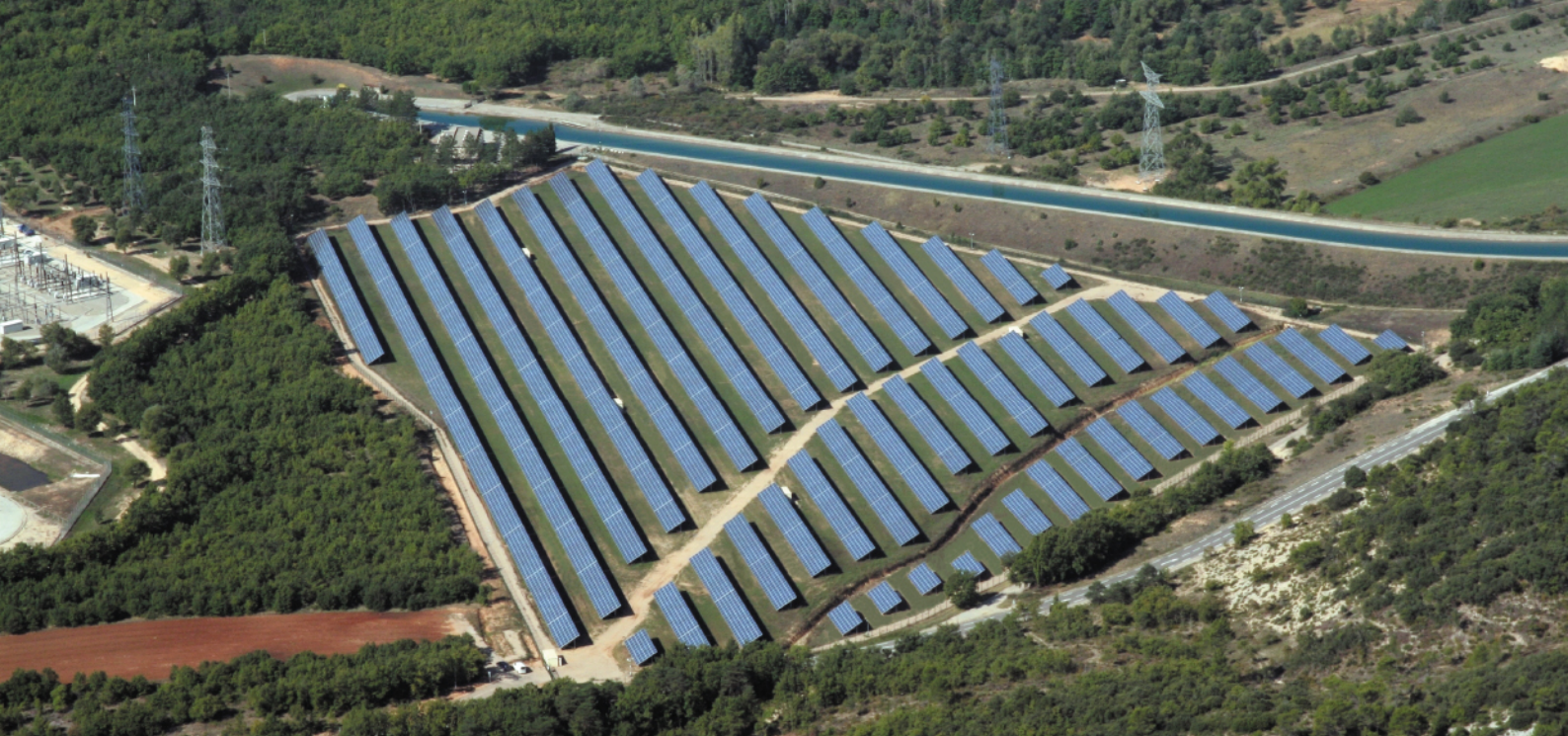
Centrale solaire de Vinon-sur-Verdon
